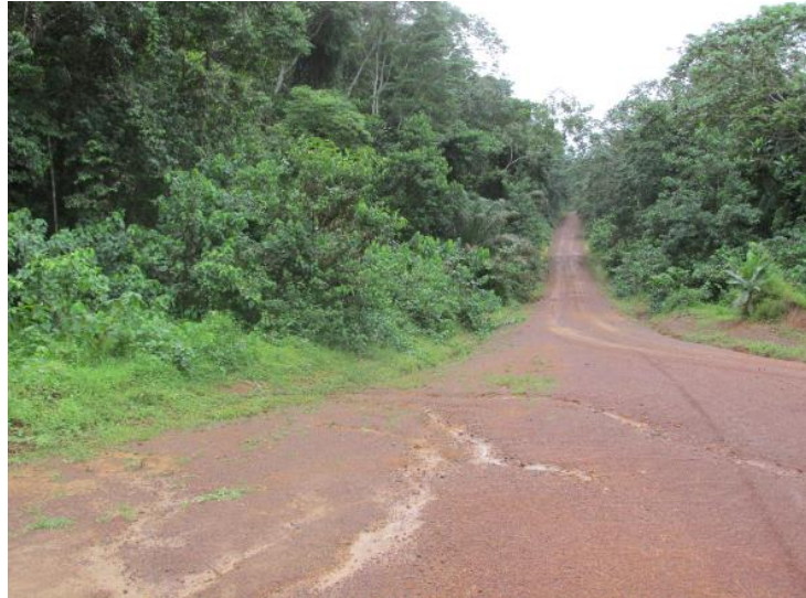
Photo 2: Etat de dégradation de la route sous l'effet de l'érosion (eaux de ruissèlement)
