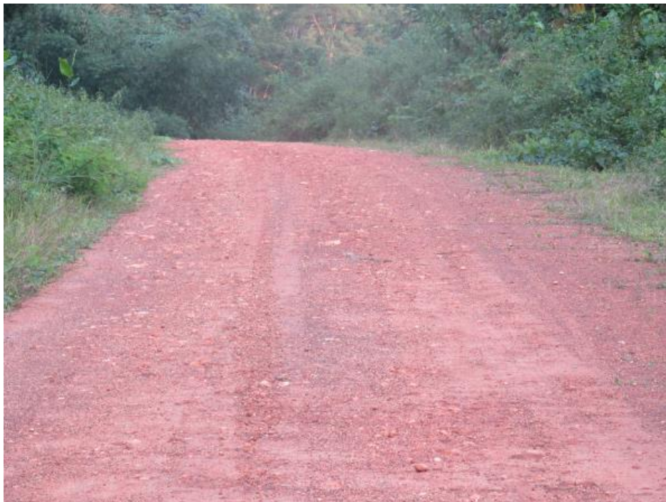
Photo 1: Etat de dégradation de la route par la perte de matériau
